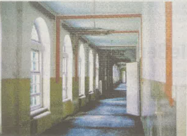
Ruinös: Die Gebäude des Sanatoriums waren nach dem Abzug der Roten Armee in sehr schlechtem Zustand. Quelle: Salusklinik
